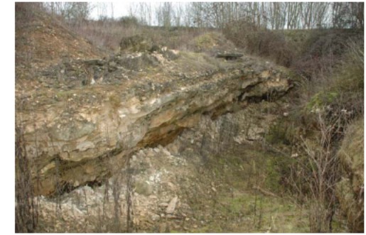
Front de taille à ciel ouvert dans le Calcaire de Caen (© J. AVOINE)
