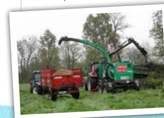
Déchiquetage des branches coupées.
